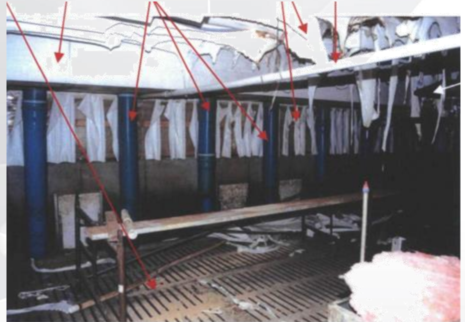
Chambre après l'explosion
