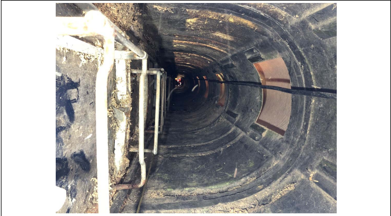
Photo 3 – Intérieur de l'échelle d'accès à crinoline
