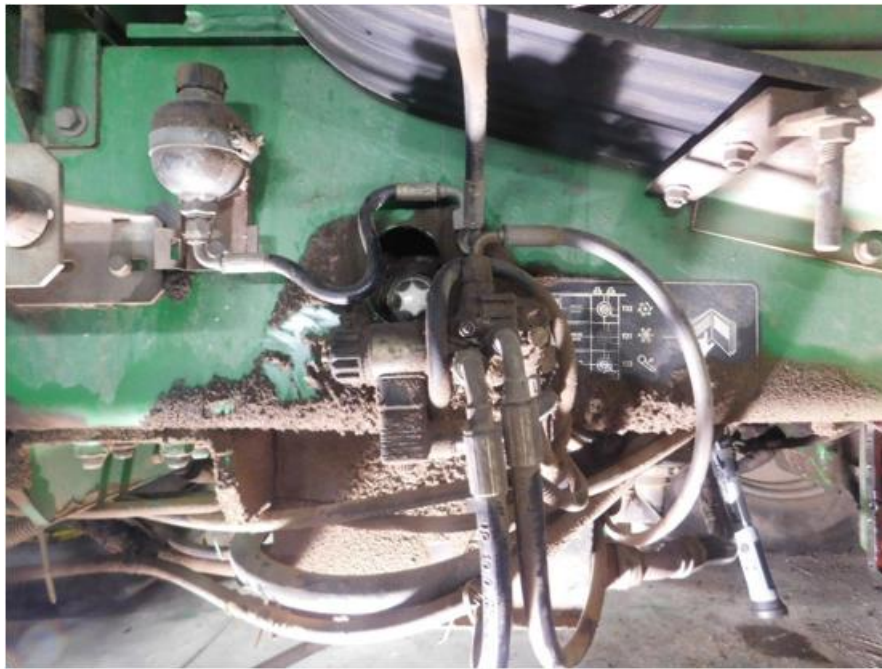
Photo 12 : Couche de poussière et de graisse autour du regard. Note : Photo prise après que le regard soit nettoyé par le mécanicien lors de l'inspection mécanique. (Source : CNESST, 24 septembre 2019)
